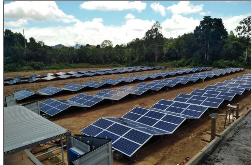
Instalasi PLTS off-grid minigrid Akuo Energy di Berau, Kalimantan
