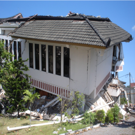
Kerusakan Gedung BPK, akibat gempabumi dari aktivitas sesar Opak, DIY (27-05-2006)
