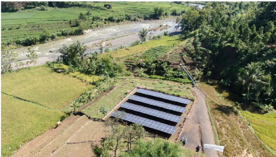
144 unit panel surya untuk PATS di Desa Kaliurip, Kecamatan Purwojati, Kabupaten Banyumas, Jawa Tengah.
