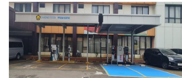
SPKL (Stasiun Pengisian Kendaraan Listrik)
